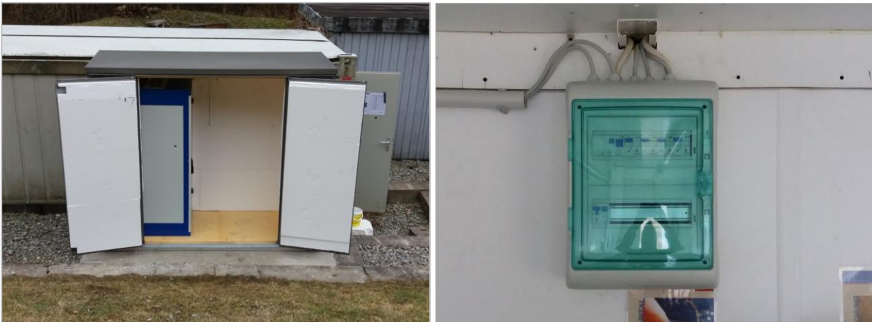
Abb. 1 Isolierter Geräteschrank und Innenschrank mit der darin befindlichen USV-Anlage (links) und der für Feuchträume geeignete Sicherungskasten (rechts).
