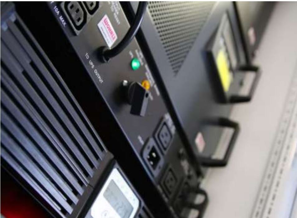
Abb. 1 Die neu installierte USV-Anlage sichert den Erntebetrieb zukünftig auch bei einem Stromausfall.
